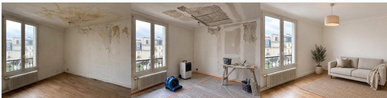
Avant — plafond et mur endommagés
